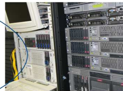
Uno dei data-center più grandi e avanzati di Prato con sistema di gestione per la sicurezza delle informazioni certificato ISO27001
